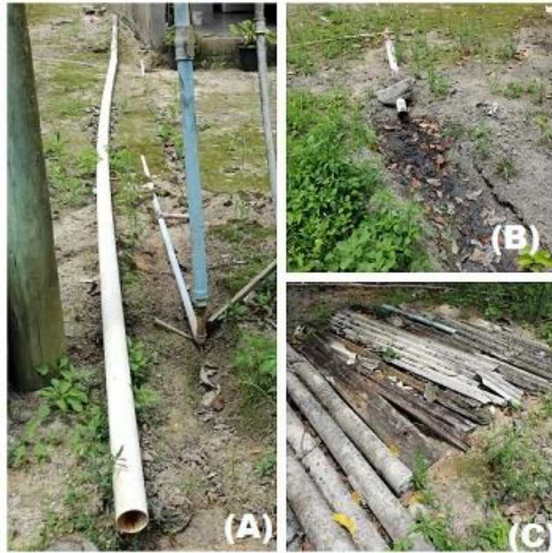
Figura 5. (A). Saída do efluente proveniente do banheiro e área de serviço. (B). Efluente da pia da cozinha. (C). Vista superior da fossa rudimentar.
