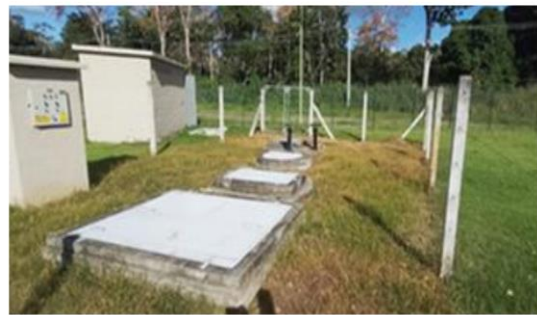
Estação Elevatória de Águas Marrons
